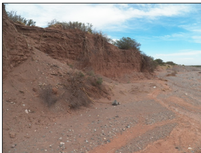
Foto 26: Se muestra una barranca afectada por desestabilización lateral del borde lateral occidental de la Cantera Municipal.
